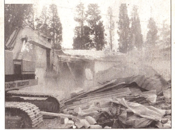
Kadıköy'de kaçak yapılaşmaya izin yok....
